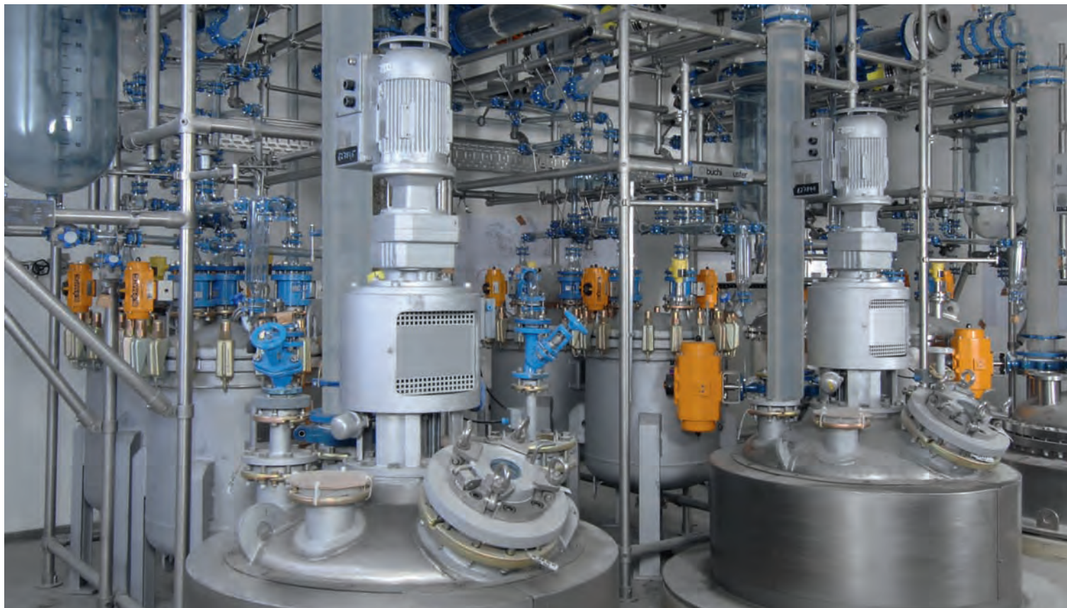
cGMP facility with 800 liter AE / BE reactors and glass upper section for API production cGMP Anlage mit 800 Liter AE / BE Reaktoren und Glasaufbau für API Produktion
